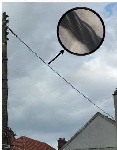
Réseau fils isolés aérien BT
